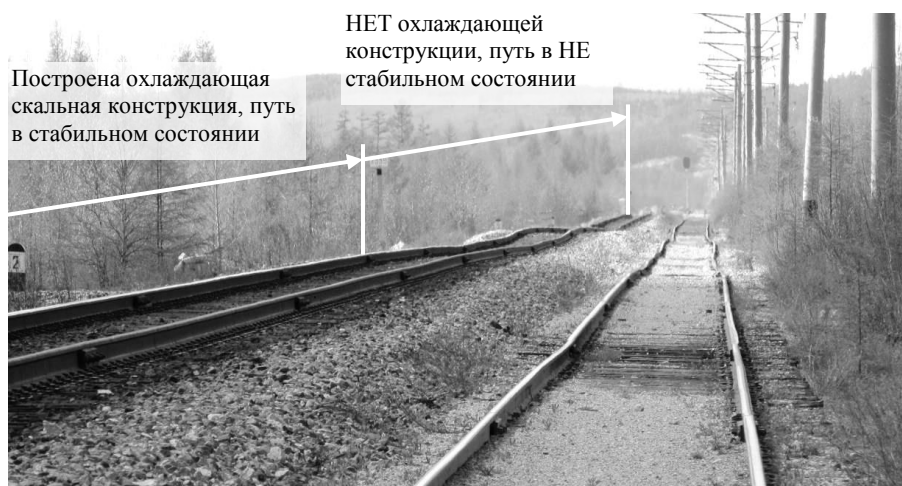
Рис. 5 – Состояние основной площадки на км 2338-2339
